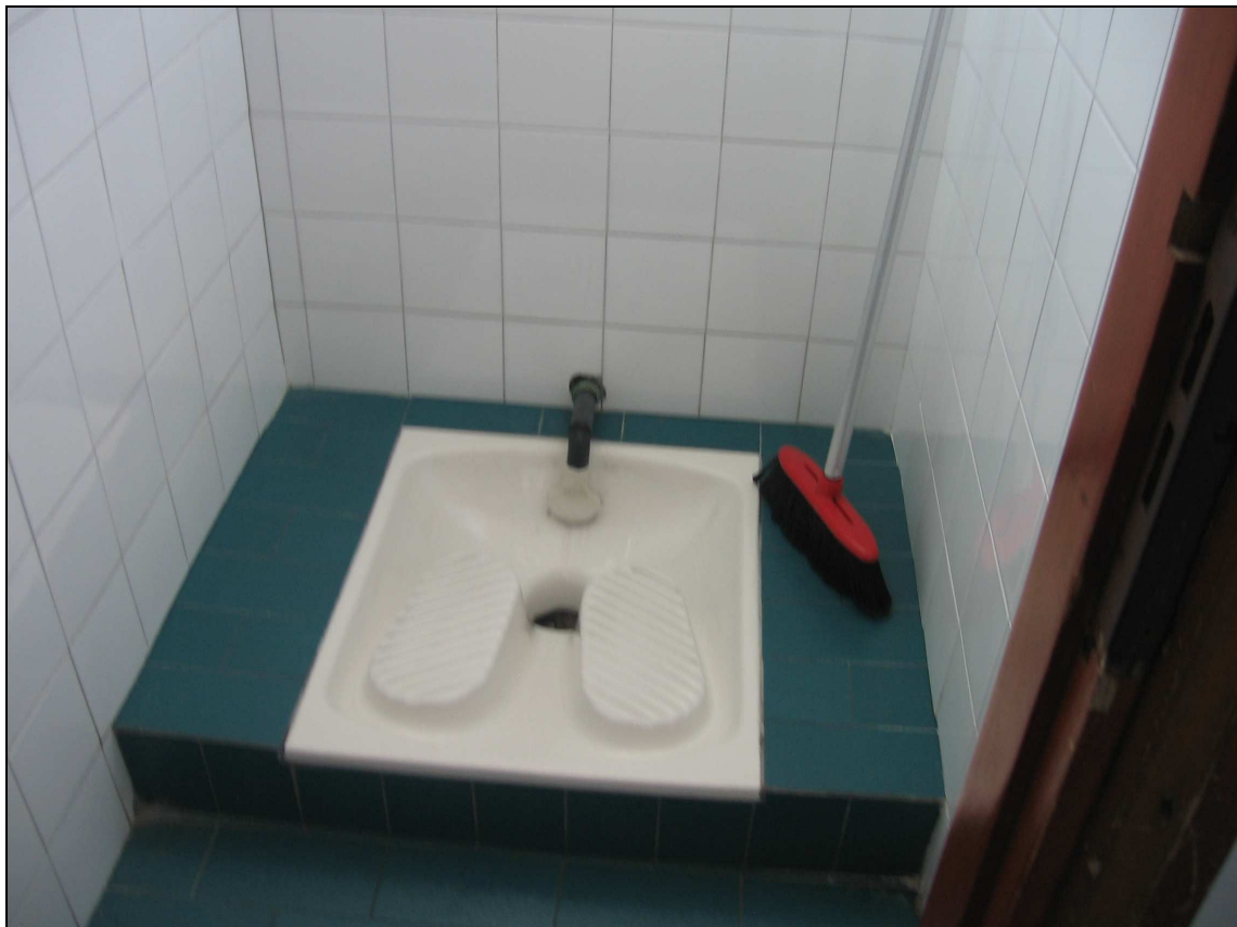
Foto n° 22 - Immagine di wc turca nel blocco bagno
