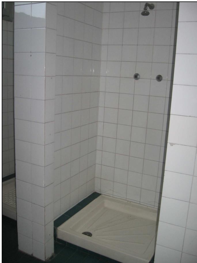
Foto n° 24 - Immagine docce blocco bagni
