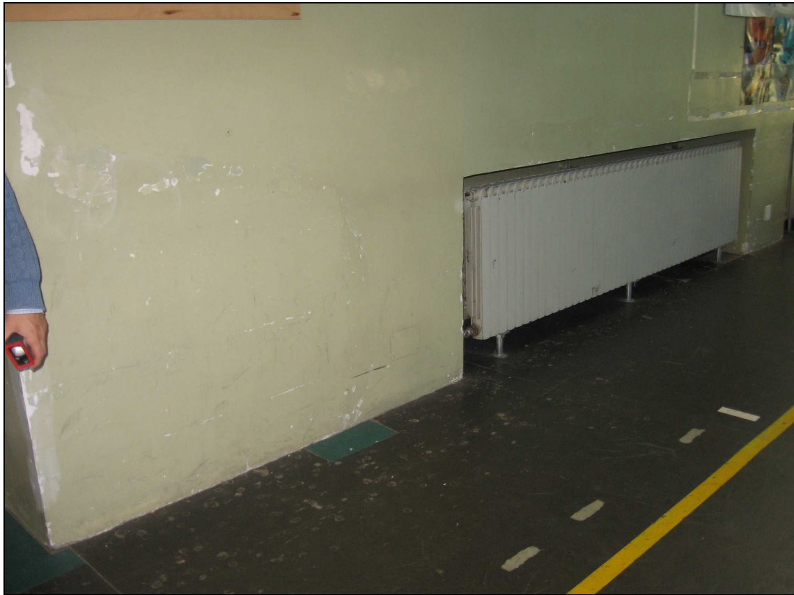
Foto n° 9 - Immagine particolare pavimento rattoppato
