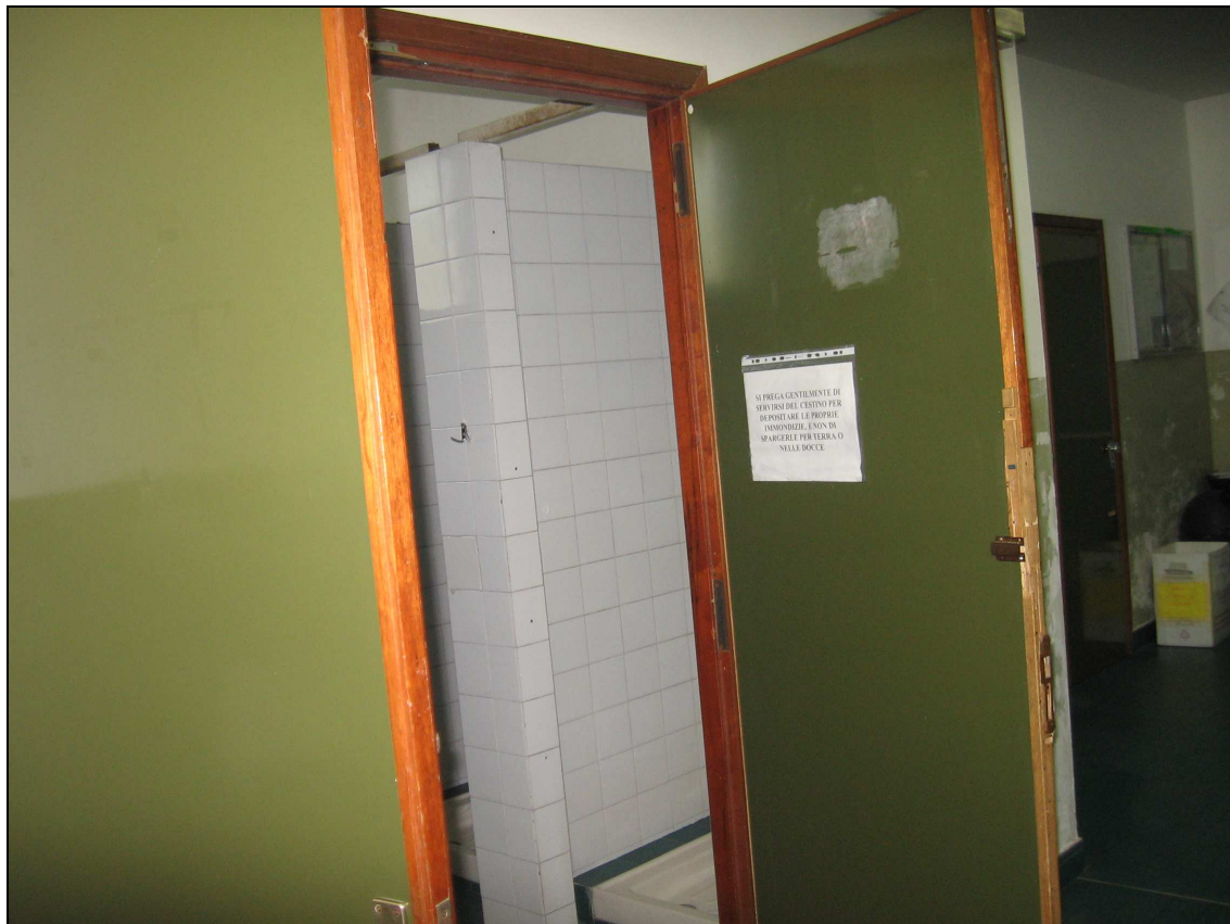
Foto n° 20 - Immagine serramenti interni blocco bagni
